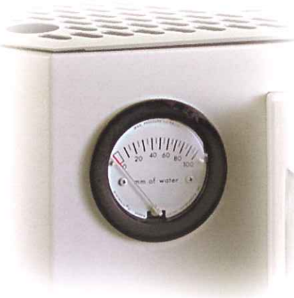
Manomètre permettant de voir le stade d'engorgement des filtres Filterverstopfungsanzeiger
